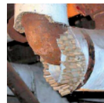
Poškodovana cevna izolacija
